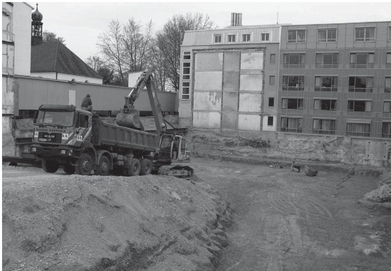
Inzwischen sind der 4. Bauabschnitt und das Ärztehaus im Zuge der Umbaumaßnahmen erreicht. Noch klafft eine tiefe Wunde im Erdreich, wo bald das hochmoderne Gebäude entstehen soll.
